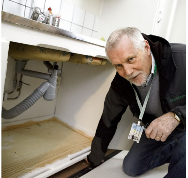
Göran Olausson visar hur avloppsröret i köket numera går in i väggen istället för ner i golvet för att minsta risken för vattenskador.
